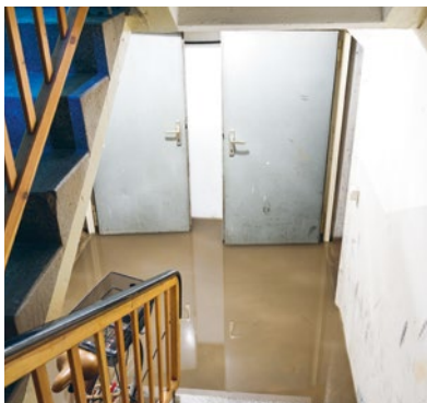
Bei starken Regenfällen kann sich – ohne entsprechende Sicherung – Abwasser aus dem Kanalsystem zurückstauen.
