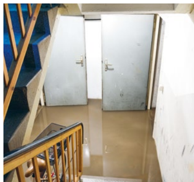
Le forti precipitazioni possono causare, in assenza di un dispositivo di sicurezza, il rigurgito delle acque di scarico dai sistemi di canalizzazione.
