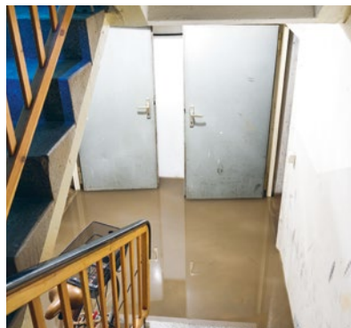
En cas de fortes pluies – et en l'absence de sécurités – un refoulement des canalisations peut se produire.
